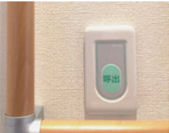
緊急通報ボタン
